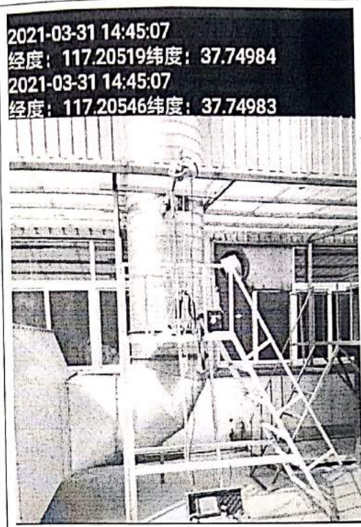
图 2-2 喷塑车间进口现场采样照片
